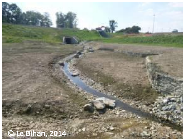
Figure 13 : Plan d'eau avec apport excessif de matériaux (après suppression)
