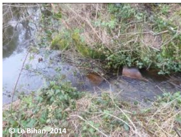
Figure 17 : Brèche obstruée par une buse installée de manière intentionnelle entraînant une remise en eau du plan d'eau
